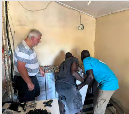
Aufbau der Speicherbatterie - Randolph
